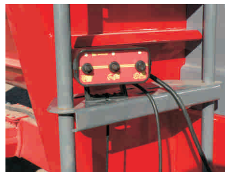
Comandos electrohidráulicos: Apertura de cinta transp. de descarga, compuerta lateral, y comando de cinta transportadora con motor hidráulico.
